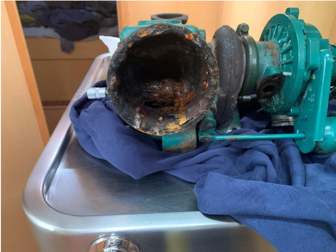
Sortie du coude après l'injection d'eau de mer extrêmement corrodé.
